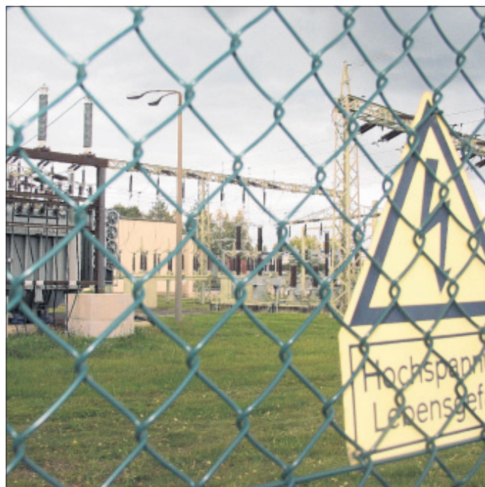
Bis Anfang 2008 soll das Umspannwerk Zerbst an der Biaser Straße generalsaniert werden. Komplette erneuert werden die Schaltanlagen. Betroffen sind sowohl die Anlagen für 110 Kilovolt als auch jene für 20 Kilovolt. Foto: Andreas Mangiras
